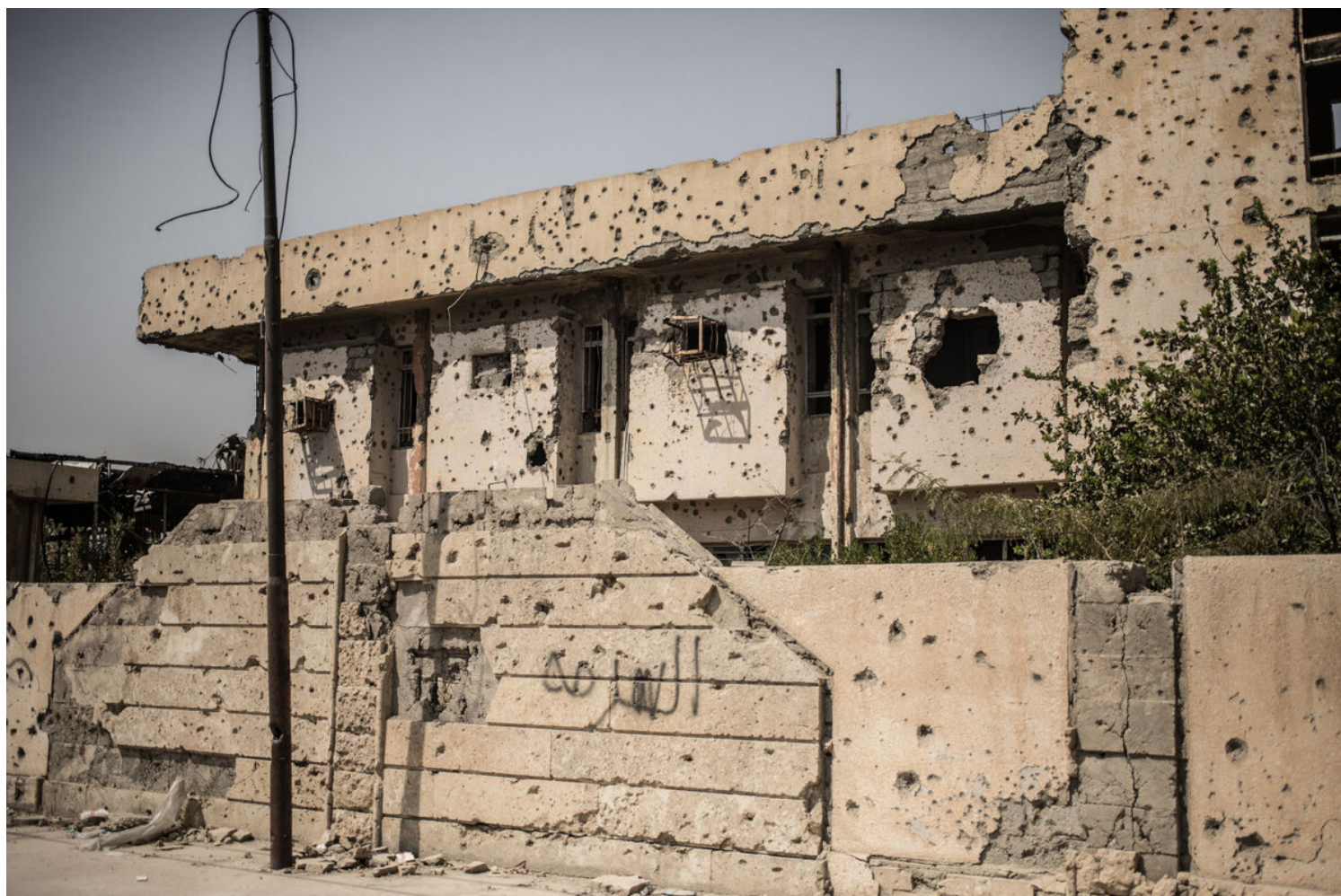
Ein zerstörtes Gesundheitszentrum in Mossul. Foto: © Florent Vergnes / HI
